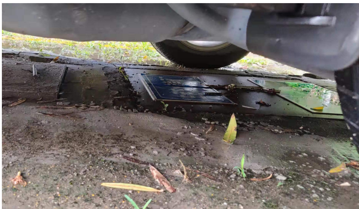
图5.1-9 生活污水排口
