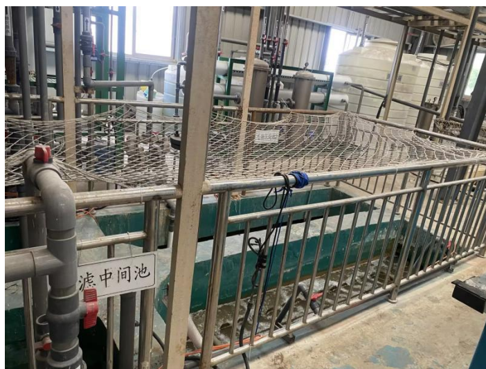
图5.1-3 废水站处理池
