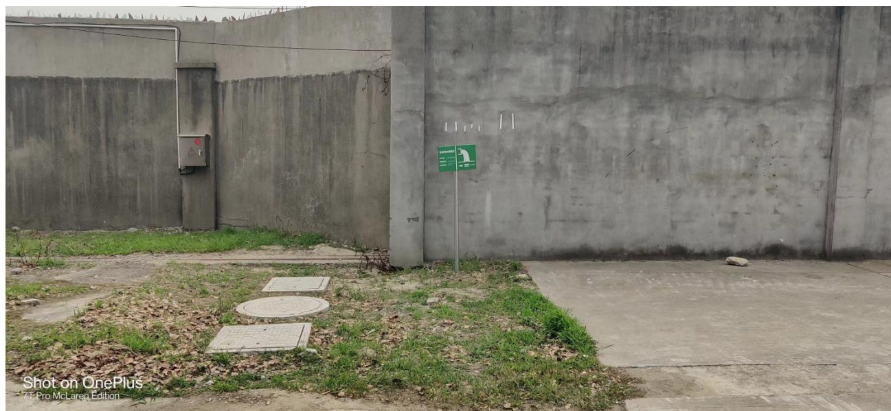
图5.1-8 生活污水排口
